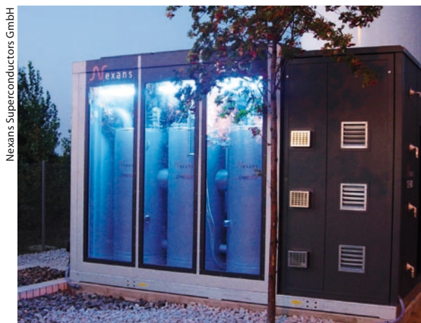
Im Kraftwerk Boxberg von Vattenfall steht dieser supraleitende Strombegrenzer.
